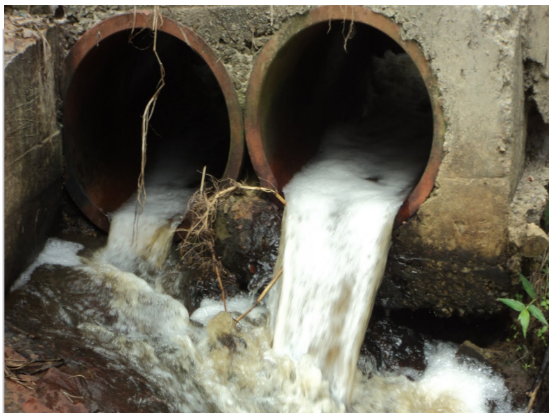
Efluente de esgoto lançado sem nenhum tratamento
